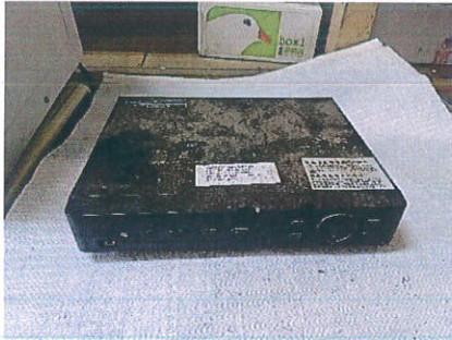
監視器主機(數量:1 件)
